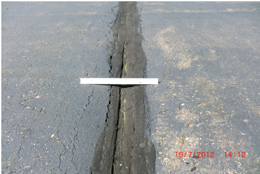
BFW RY725 001 L & T Cracking (PCI = 65)
