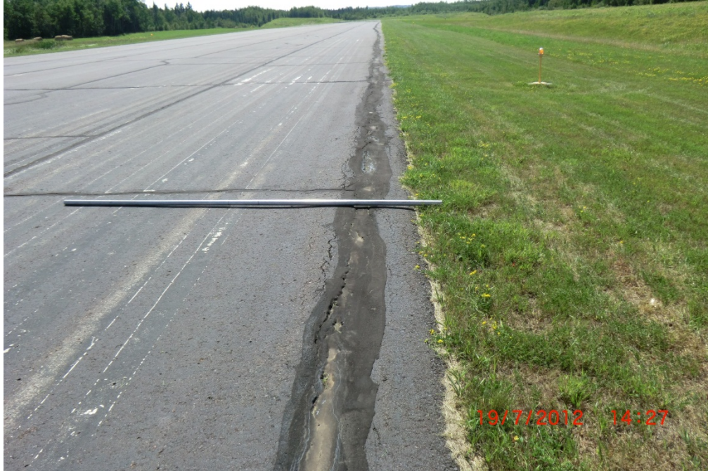
BFW RY725 001 Edge Cracking (PCI = 65)
